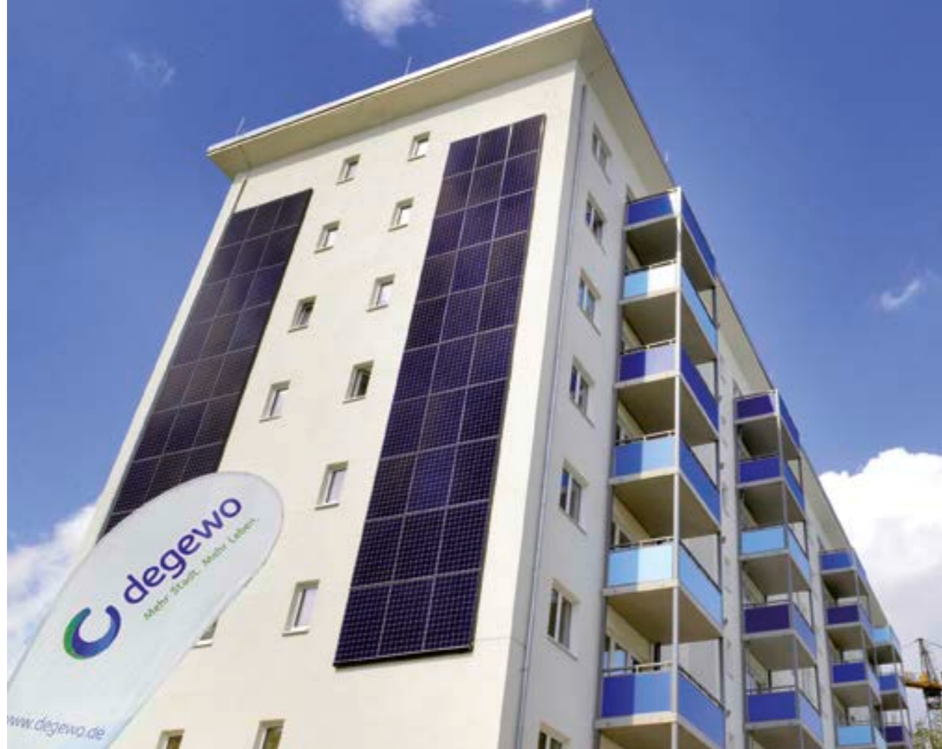
Energiewende: Solarmodule an der Fassade und auf dem Dach wandeln Sonnenenergie in Wärme und Strom um.
